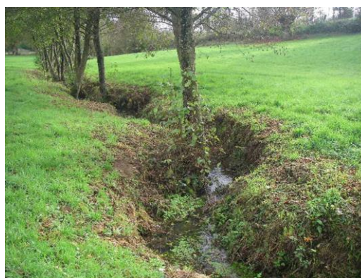
Ripisylve clairsemée, des encoches d'érosions peuvent se former entre les systèmes racinaires. Ruisseau de la Roussette
